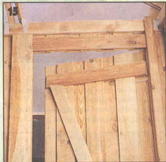
15 Дверное полотно делают как элемент стены. Сначала к стойкам привинчивают петли, крепят обшивку, а затем выпиливают дверное полотно.
