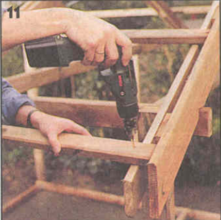
11 Рейки обрешетки подгоняют между лобовыми досками наружных стропильных ферм и крепят к стропилам шурупами с потайной головкой.
