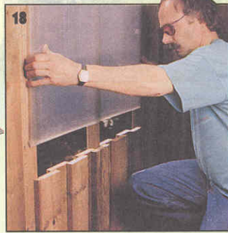
18 В зоне окна стену обшивают более короткими досками, оставляя проем. Полосу светопроницаемого пластика крепят изнутри фальцованными брусками, а снаружи — деревянными уголками.
